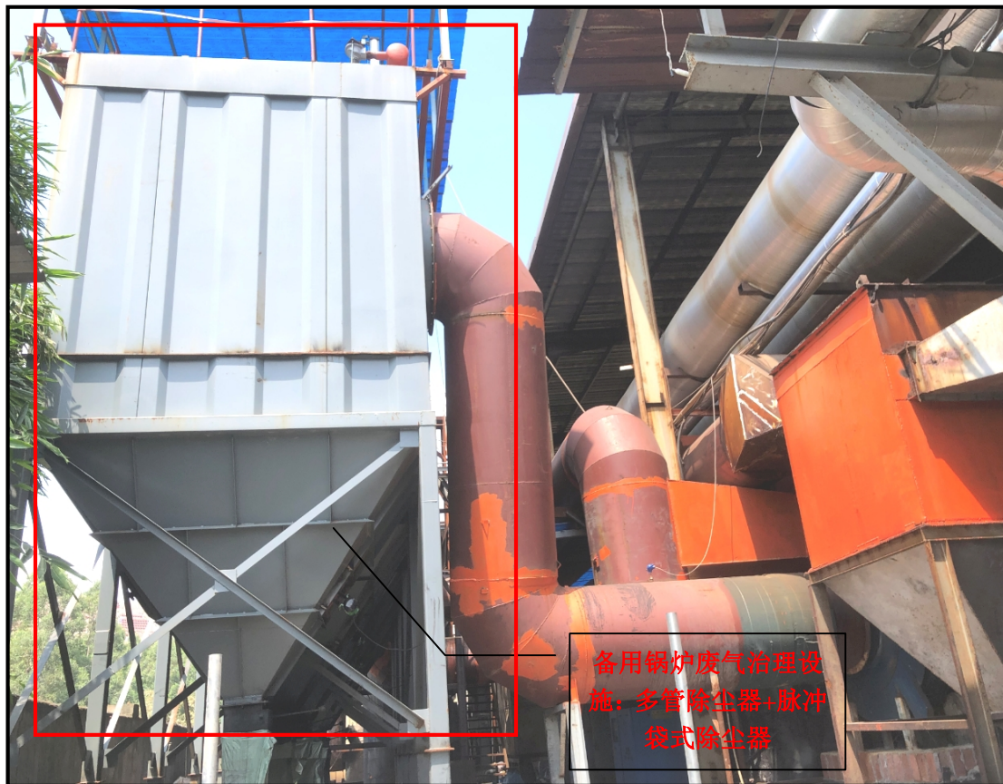
图 4.1-6 项目废气治理设施现场拍摄图 (1)
