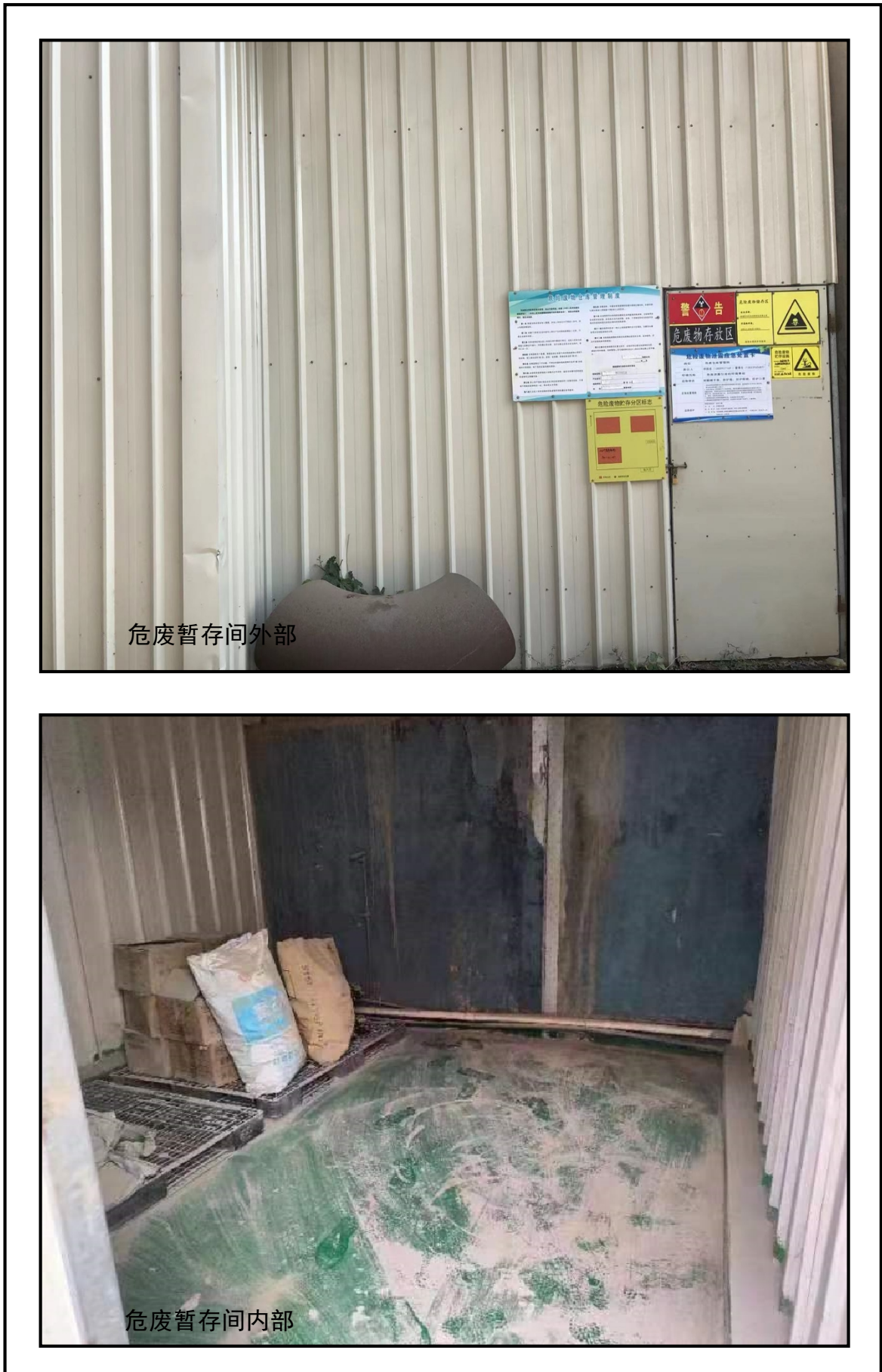
图 4.1-9 项目危废暂存间现场拍摄图
